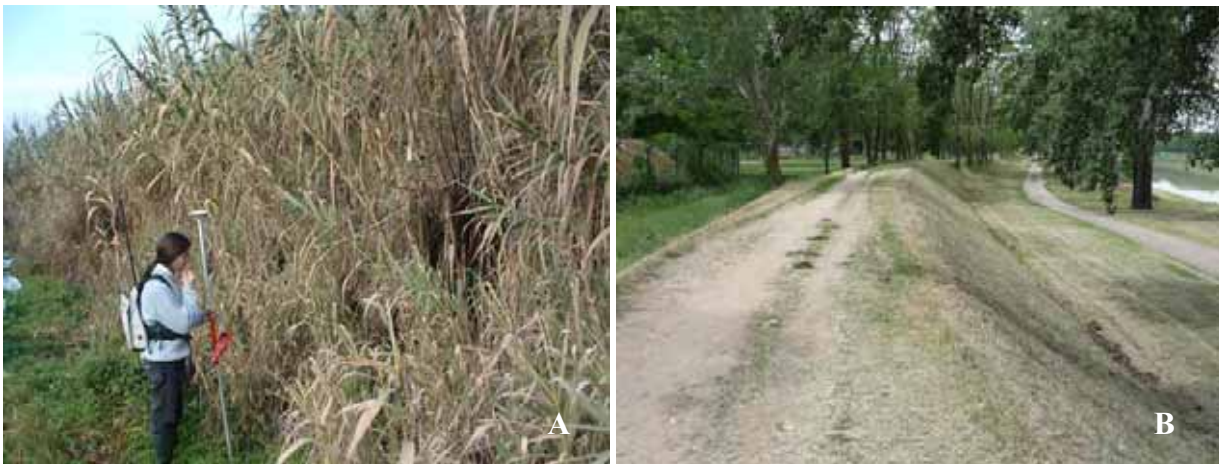
Fig. 4.20 - Fianco arginale interno ricoperto da fitta vegetazione di canne (a valle di Signa) (A), vegetazione ad alto fusto a ridosso del rilevato arginale (pressi di Ponte di Varlungo) (B)
