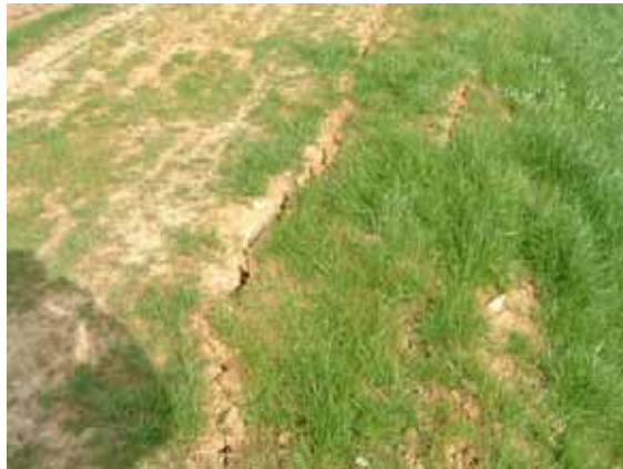
Fig. 5.151 - Cedimento di un fianco dell'argine (Vingone)
