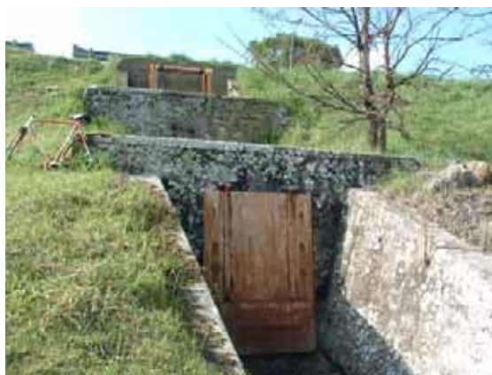
Fig. 103 – Scarico con serie di portelli (mannaia e ventola)
