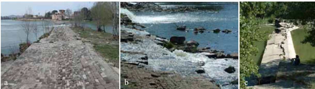
Fig 5.146 – Interramento, crescita di piante e crolli (Pescaia S.Andrea a Rovezzano) (a), Scalzamento di blocchi e sifonamento (Pescaia delle Sieci) (b), Lesioni e fratture (pescaia Mulino Nuovo) (c)
