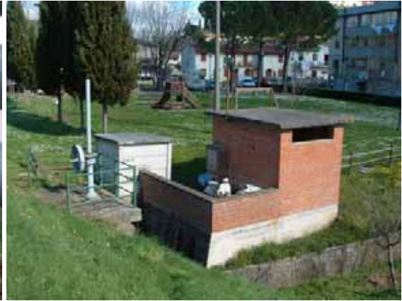
Fig. 5.44 – Impianto idrovoro in prossimità di una cateratta
