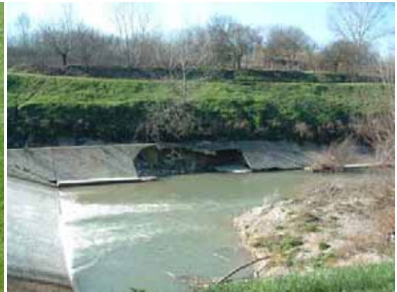
Fig. 5.152 - Collasso del muro d'ala di una pescaia (Greve)
