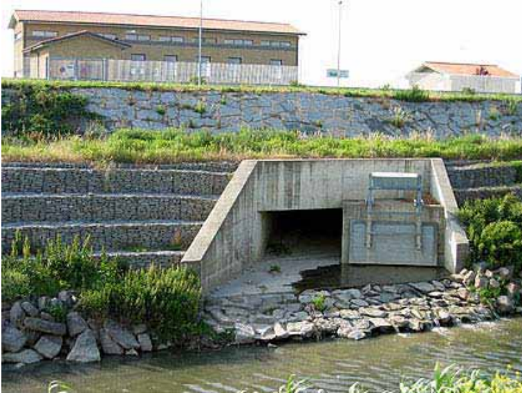
Fig. 5.72 – Particolare dell'impianto di Fosso di piano
