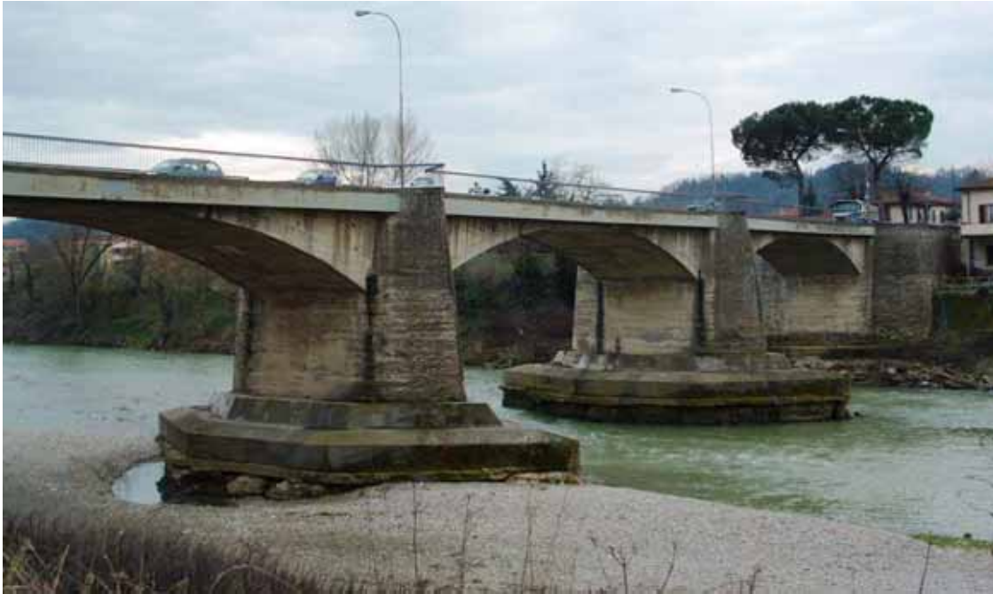
Fig. 5.54 – Ponte stradale in località Figline Valdarno.: fu ricostruito nel dopoguerra e consolidato nel 1962
