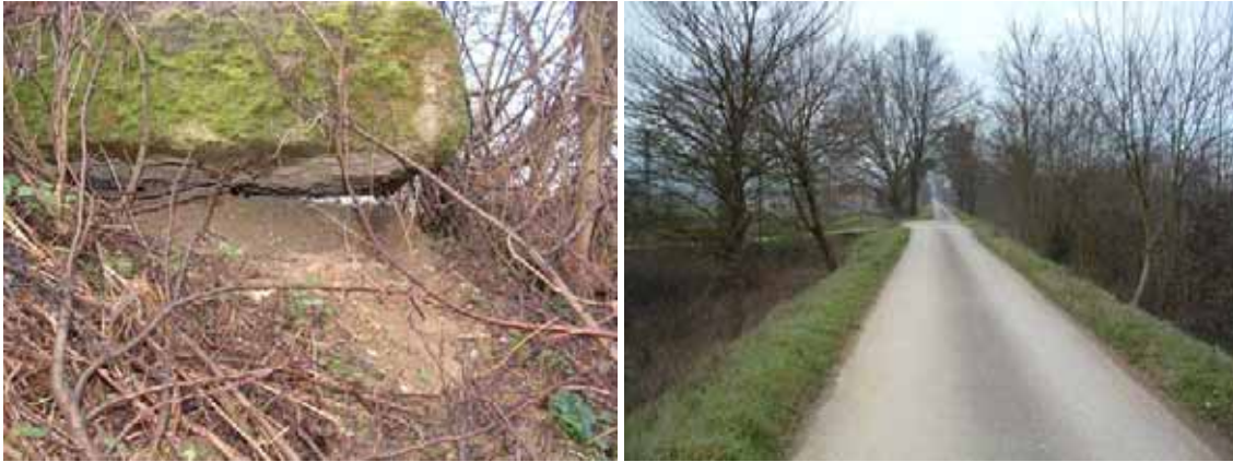
Fig. 5.139 – Scalzamento delle fondamenta di un gasdotto Fig. 5.140 – crescita di vegetazione sui fianchi arginali
