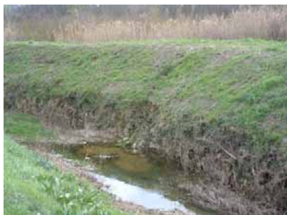
Fig. 5.147 - Crollo di un muro di protezione (Vingone)
