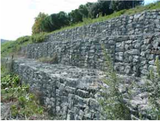
Fig. 5.79 – Gabbioni come difesa spondale
