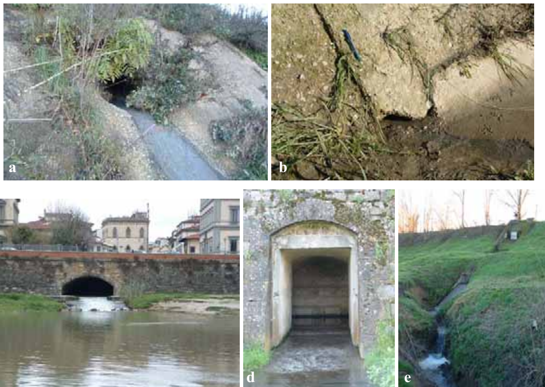
Fig. 5.56 – Fogna con liquami (a) e relativa perdita attraverso il rivestimento circostante (b). Sbocco di torrenti tombati in Firenze (c, d). Erosione concentrata allo sbocco di un sistema fognario (e)
