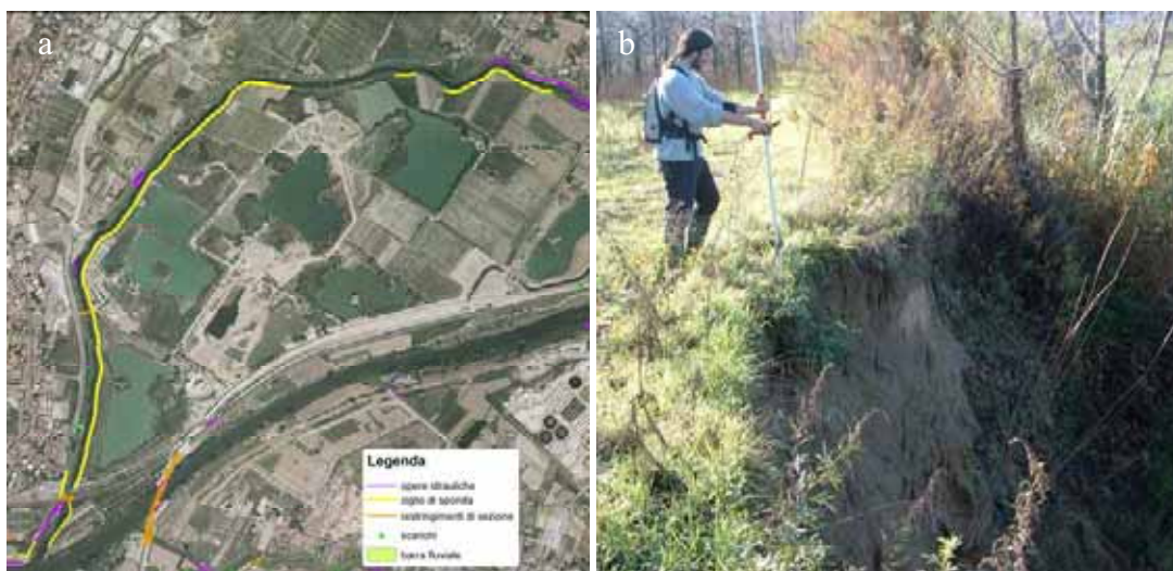
Fig. 5.61 - Ciglio di sponda in prossimità dei Renai (Signa) (a) e arretramento attivo in prossimità della foce (b)
