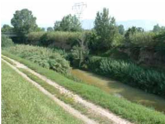
Fig. 5.98 – Ciglio di sponda con tratti in arretramento
