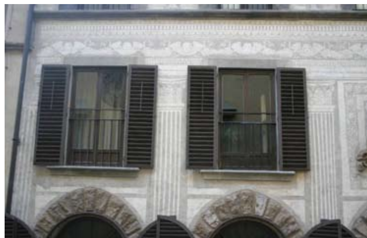
Palazzo n° 28, dettaglio dell'apertura delle finestre con distruzione di parte della decorazione
