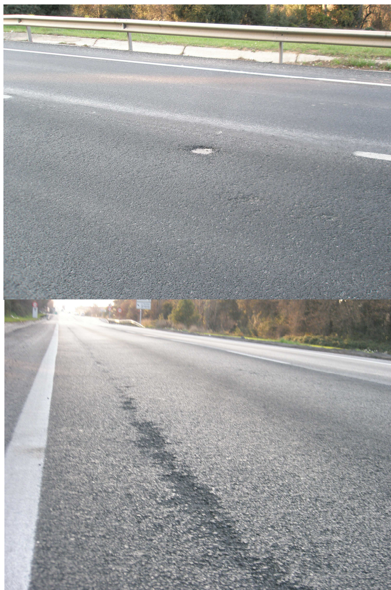
Fig.3.17 Detalle de las disgregaciones y desprendimientos de la mezcla con tipo de betún BMPN+2% vía seca.
