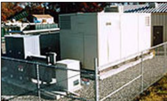
Fig. 4.4.5.8. Exemple n°1 de pila estacionària (font: Fuel Cells 2000)
