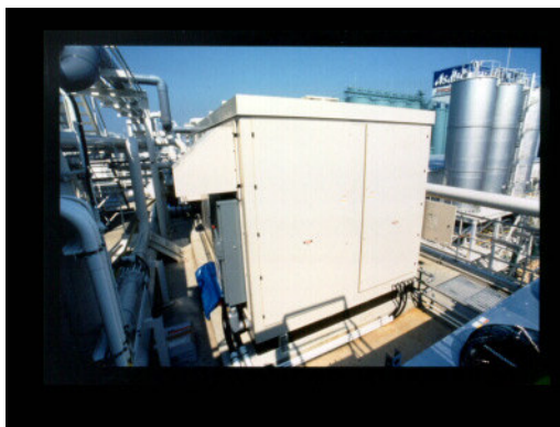
Fig. 4.4.5.10. Exemple n°3 de pila estacionària (font: Fuel Cells 2000)
