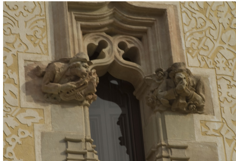
Finestres de planta primera
