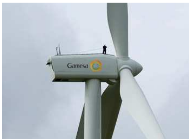
Figura 3.3. Caixa d'un aerogenerador (Font: Gamesa).
