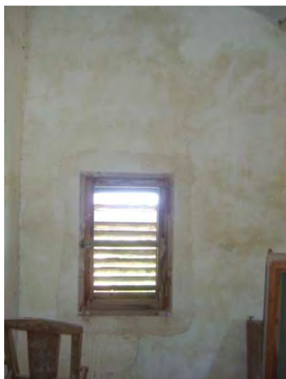
Foto 14. Cap. 6: Humedades muro suroeste
