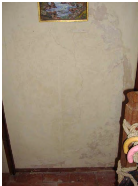
Foto 6. Cap. 6: Grieta vertical a la izq. de la puerta
