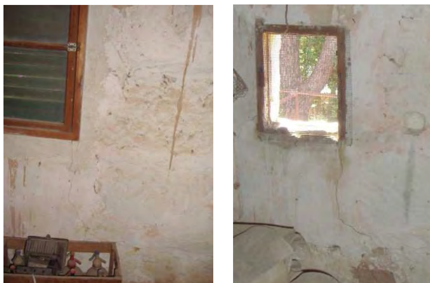
Foto 18. Cap. 6: Grieta en la esquina derecha de ambas ventanas
