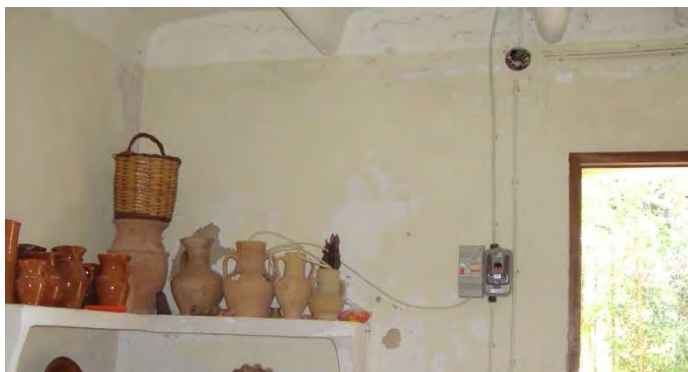
Foto 11. Cap. 6: Zona de desprendimientos
