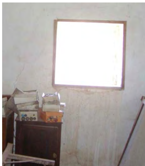
Foto 15. Cap. 6: Grieta bajo ventana muro noroeste
