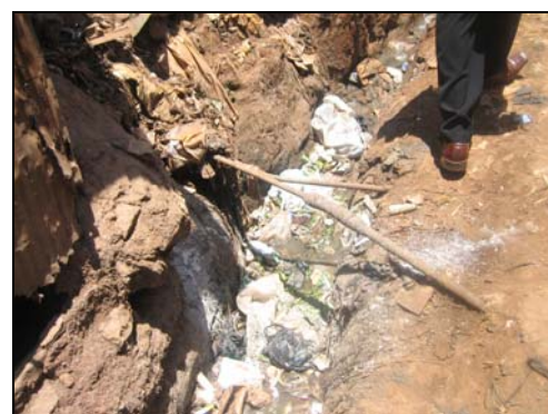
Fotografía 2: Drenaje natural y contaminación de las tuberías de agua potable
