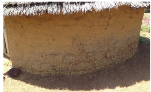
Figura 8.3.3.3. Filtracions per capil·laritat en mur de fàbrica d'adob. FONT: pròpia
