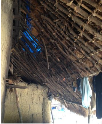
Figura 4.1.3. Porxo perimetral exterior. Col·locació d'un plàstic entre l'estructura de coberta i l'acabat de palla per solucionar problemes puntuals de goteres.
