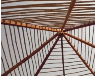
Figura 6.2.3.7. Vista interior de l'estructura de coberta. Bigues principals de fusta i biguetes de bambú africà. La resolució de les unions es realitza de manera manual per mitjà de claus.
