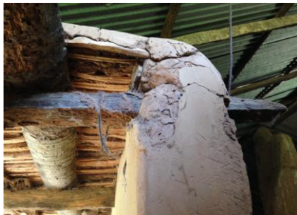
Figura 4.2.7. Emportament d'una bigueta del forjat superior.
