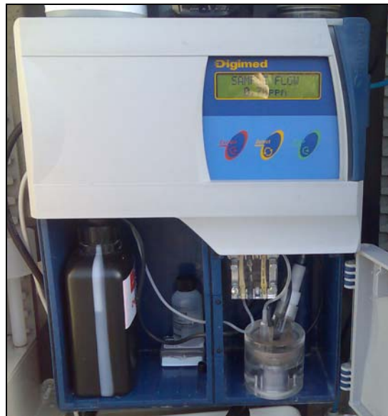
Figura 4.8 Amonia Analyzer en la planta
