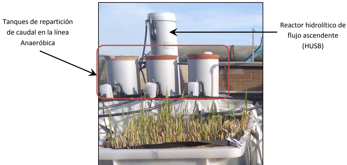
Figura 4.4: Reactor HUSB y tanques de repartición
