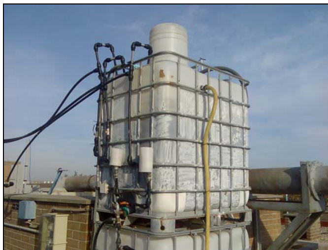
Figura 4.2: Tanque de agitación
