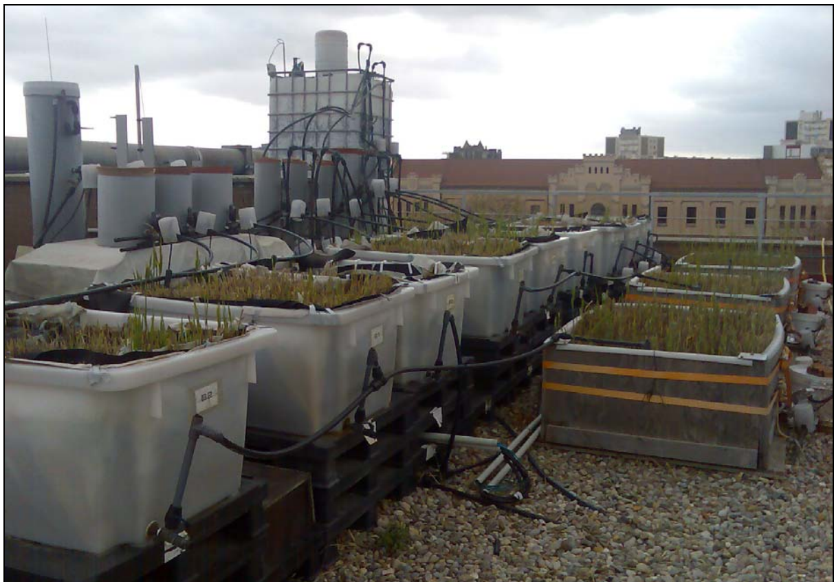
Figura 4.1: Vista general de la planta piloto
