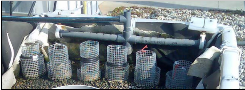
Figura 3.3 Arqueta de Repartición del agua de entrada.
