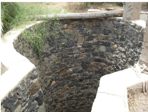
Imagen 26. Pozo artesano de muy buena construcción de Fundo das Figueiras
