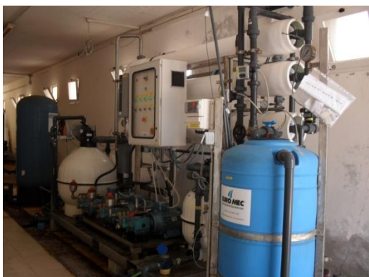
Imagen 29. Desaladora de pequeño caudal del Hotel Marine Club (Sal Rei)
