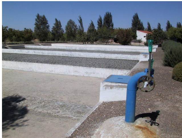
Imagen 1. Ejemplo de eras de secado en la EDAR de Argamasilla de Alba (Ciudad Real). Fuente: http://usuarios.arsystel.com/raulh
