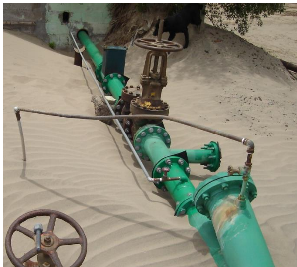
Figura I. 4. Conexión de salida del pozo 3, continuación
