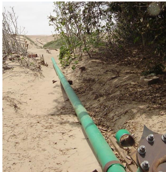
Figura I.5. Tramo de tubería de impulsión del pozo 4
