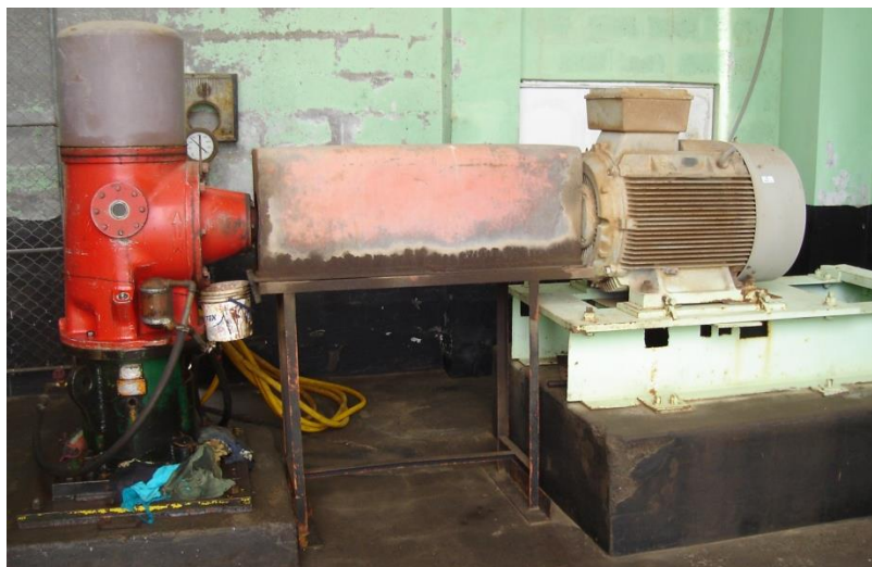
Figura I.2. Bomba actual del pozo 4
