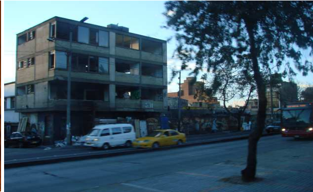
Construcciones deterioradas, basuras y escombros que reducen el tránsito peatonal
