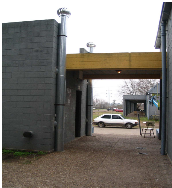
Fig. 7 - Ubicación de los aspiradores eólicos
