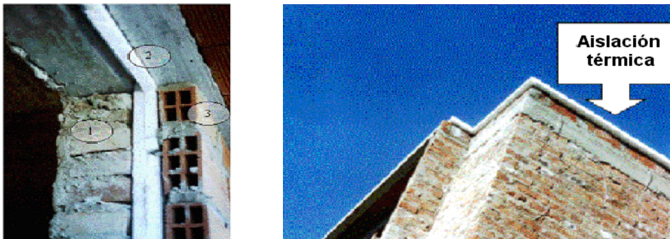
Figura 2. Vista de la composición de los muros exteriores (1: ladrillo macizo; 2: poliestireno expandido; 3: ladrillo cerámico) y de la cubierta del edificio.
