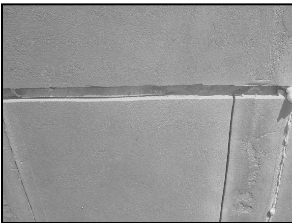
Figura 2. Detalle de las buñas realizadas para delimitar las distintas zonas del muro
