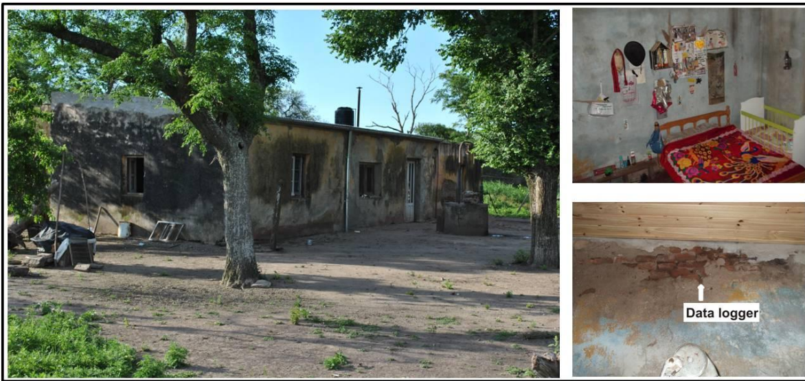
Figura 3-9 Domicilio de la provincia de Córdoba. Vista general de la vivienda. Der-abajo: "data logger" colocado en una grieta de la pared.
