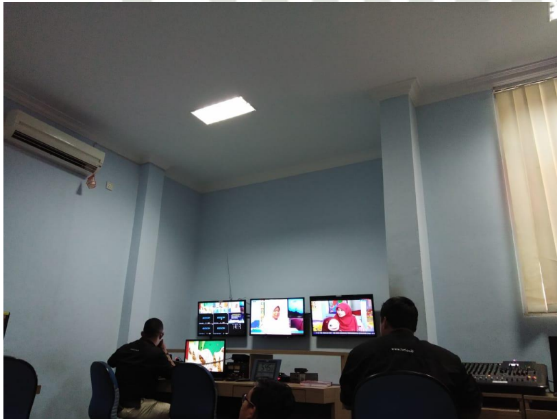
GAMBAR 2 Suasana di ruangan Master Control Room (MCR)
