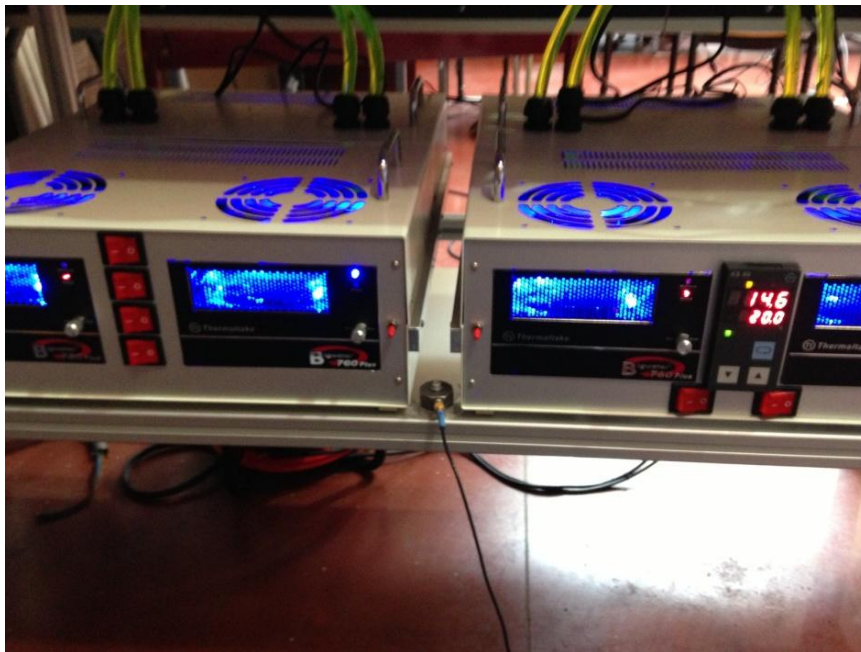
Ilustración 8 Sistema de refrigeración de cámara reológica constituido por cuatro ventiladores
