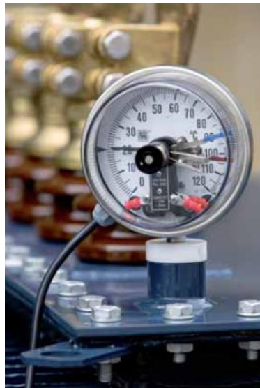
Figura 18. Termómetro (Fuente: Schneider Electric)
