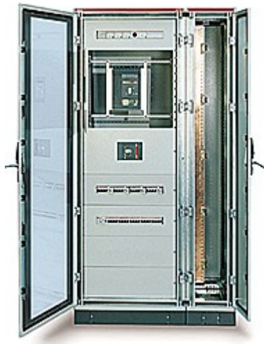
ILUSTRACION 10: CUADRO GENERAL DE BAJA TENSION
