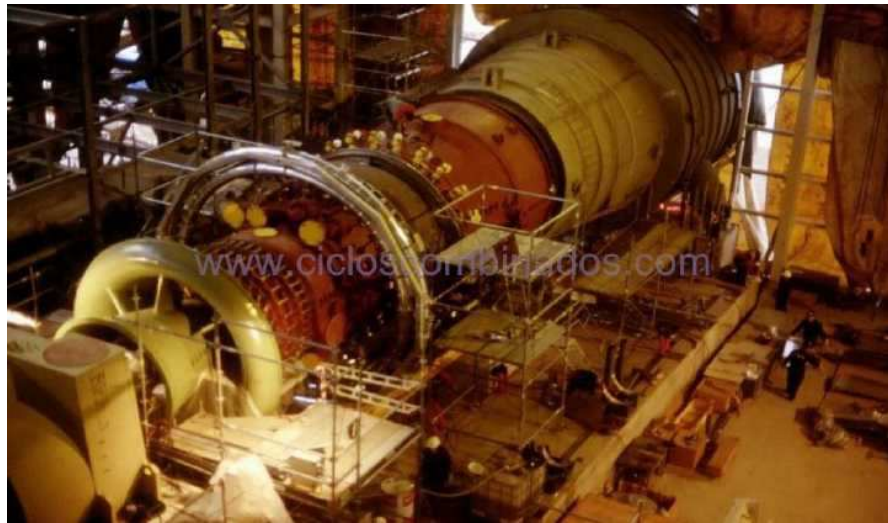
Figura 20. Turbina de uso industrial para producir electricidad.
