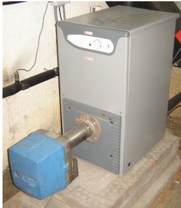
Figura 31. Caldera de gasoil
