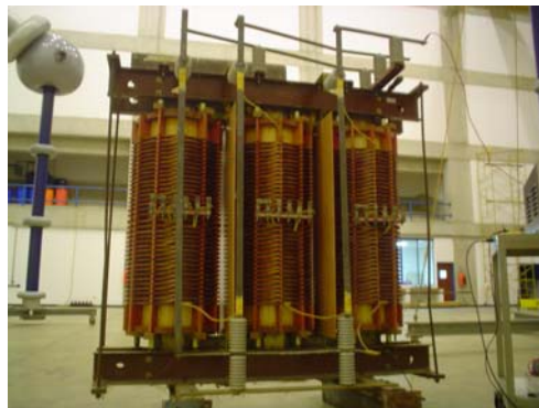
Figura 5.1.1 Transformador de distribución
