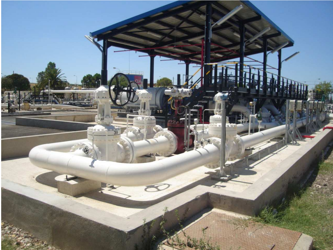
Figura 122 Vista del bombeo del “Nuevo Rotaza” desde la válvula de control
