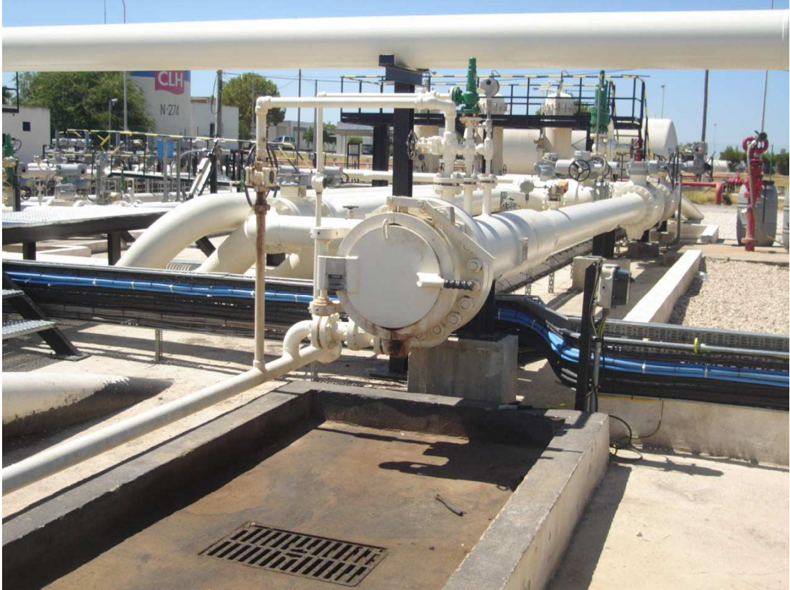
Figura 94. Foto de trampa de rascadores. Trampa de recepción del oleoducto Huelva-Málaga
