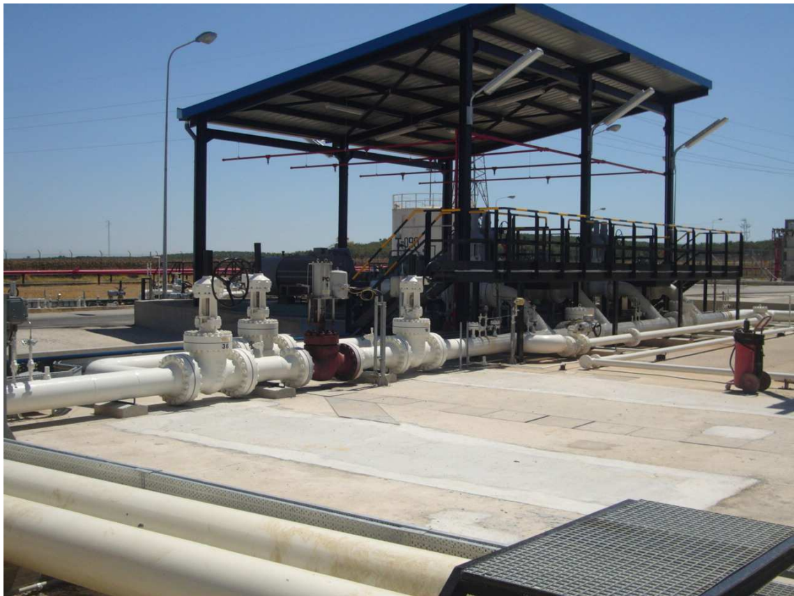
Figura 120 Válvula de control del oleoducto del Antigua Rotaza
