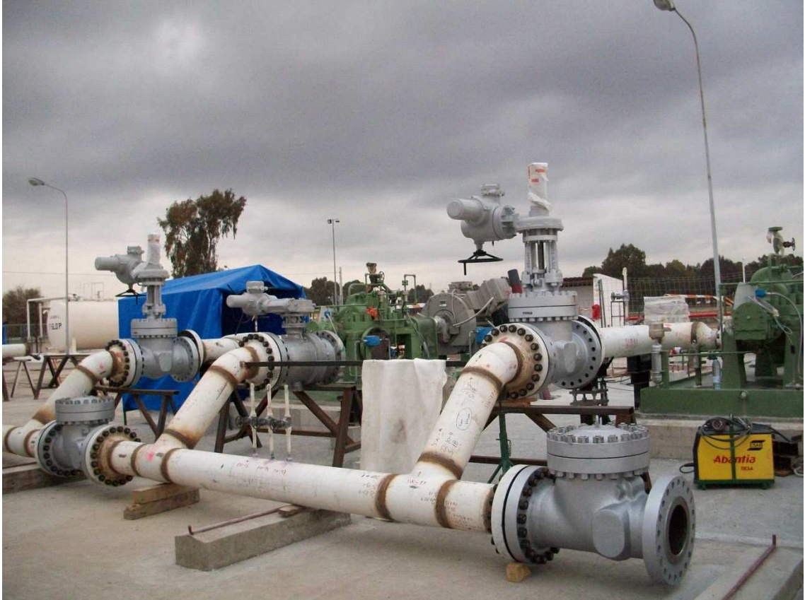
Figura 65. Durmientes en zona de bombas MBP-7/8
