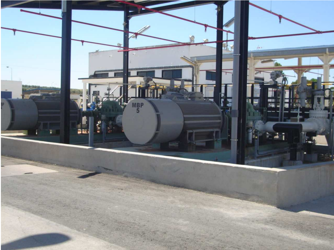
Figura 121. Bombas MBP-4 y 5 del oleoducto del Antiguo Rotaza en servicio.
