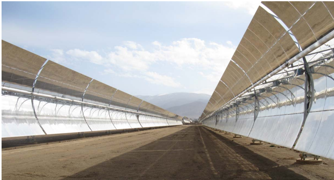
Ilustración 2: Serie de colectores solares en el campo. Fuente: © Solar Millennium AG.
