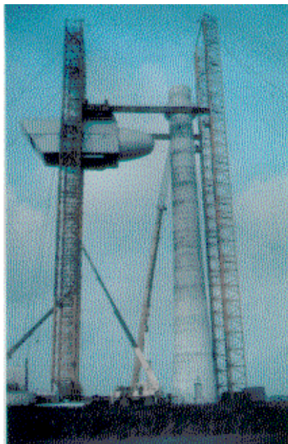
Figura 2.37: Aerogenerador con torre de hormigón
