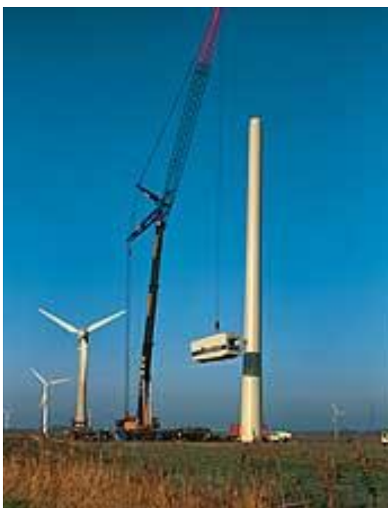
Figura 2.39: Aerogenerador con torre tronco-cónica de acero
