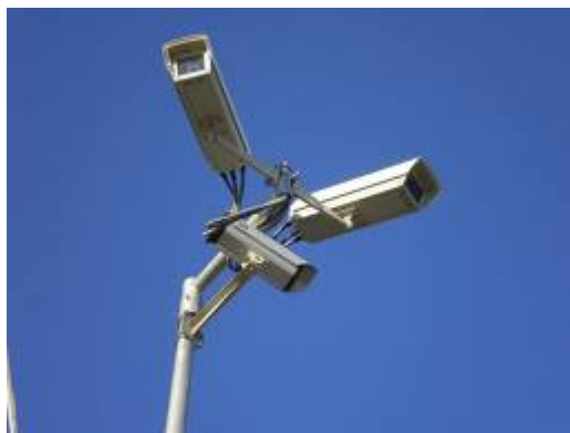
Figura 3: Cámaras de Seguridad
