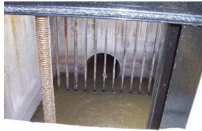
Figura 2-1, Rejas pozo de gruesos.
