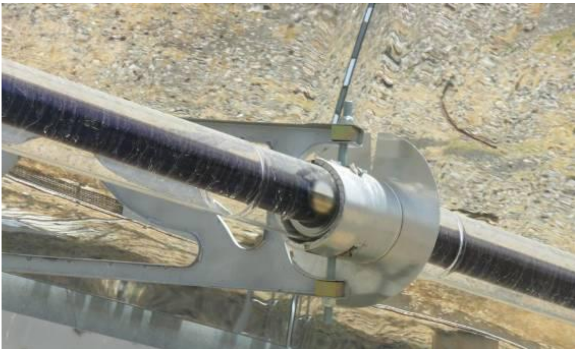
Ilustración 53: Tubo absorbedor con suciedad.
