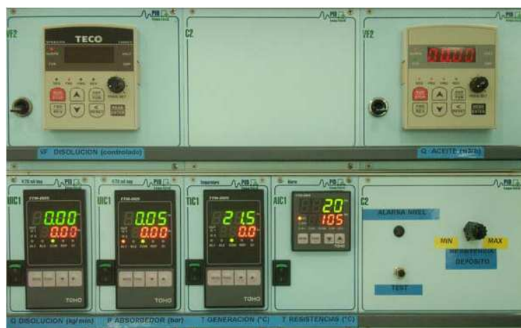
Figura 4.12 Caja de control de la instalación.
