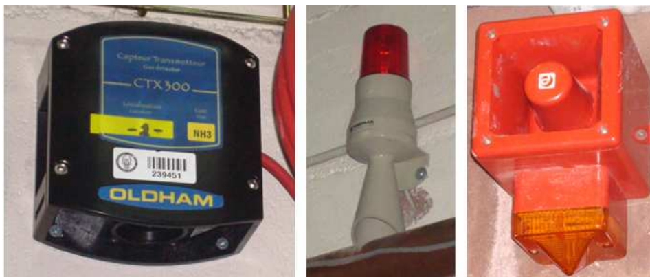
Figura 4.15 Detector de gases y sirenas acústicas.
