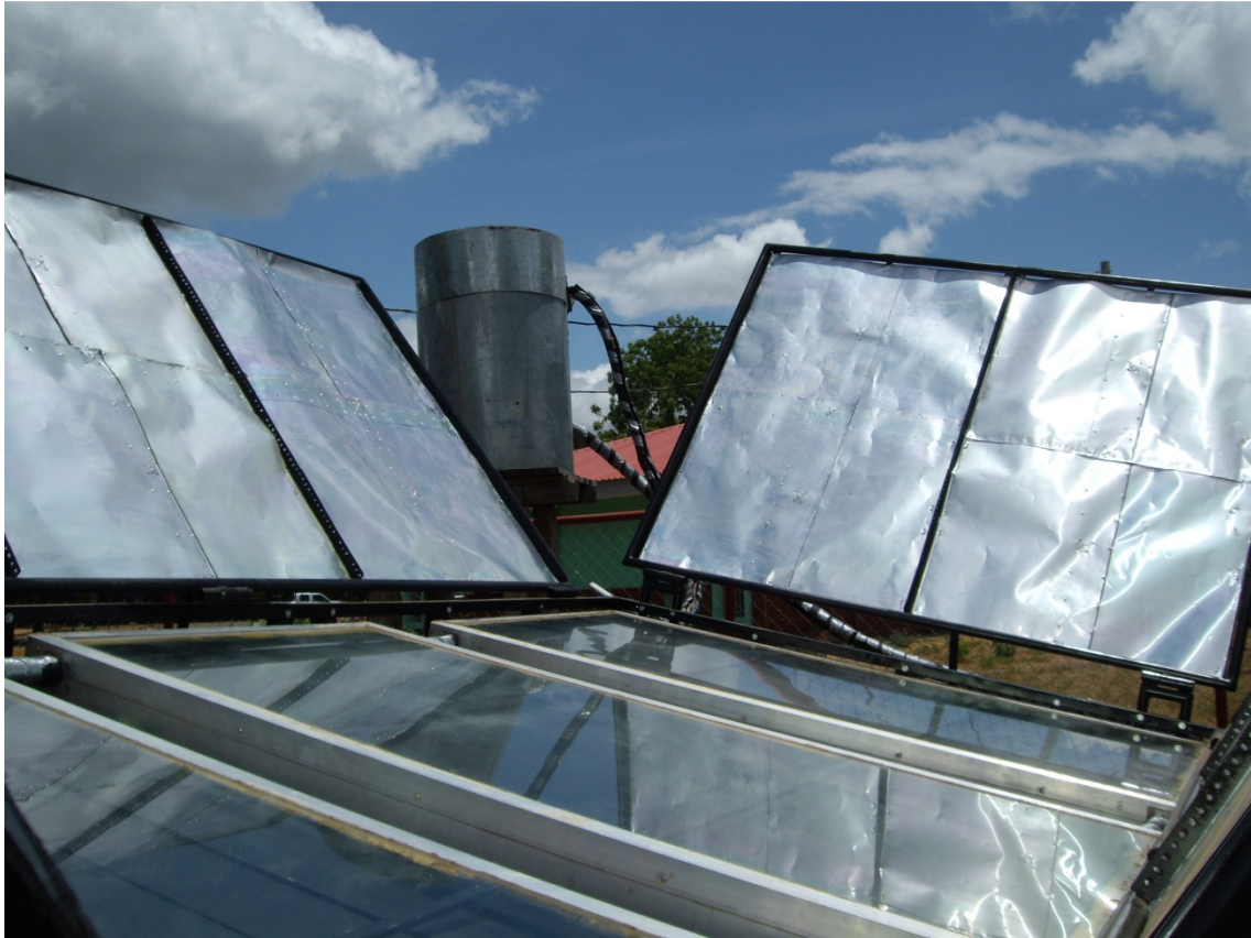
Figura 8.5 Foto del circuito primario
