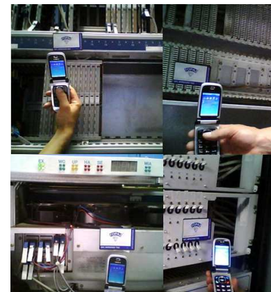
Figura 10. Partes de la central de entrenamiento etiquetadas
