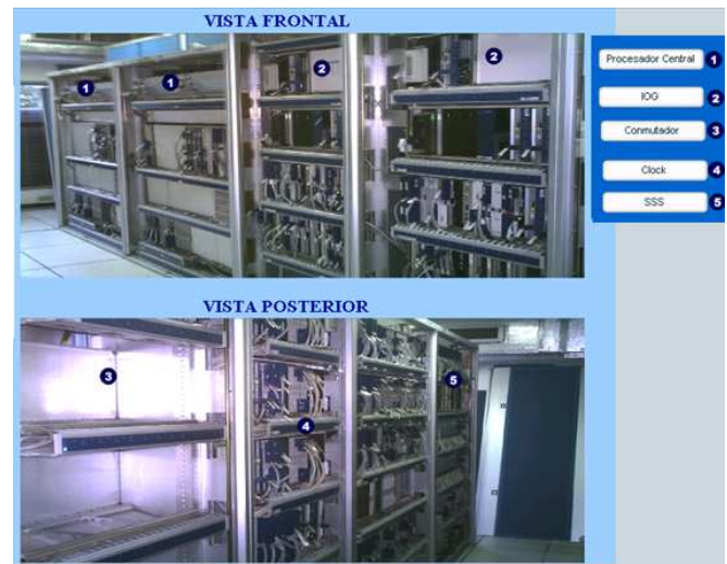
Figura 9. Vista general y partes de la central de entrenamiento
