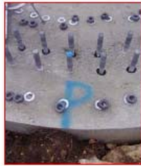
Figura E.13. Marcado de perno de puerta de entrada a torre
