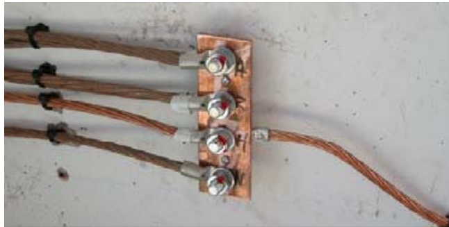
Figura F.10. Punto de conexión de tierras de caseta prefabricada
