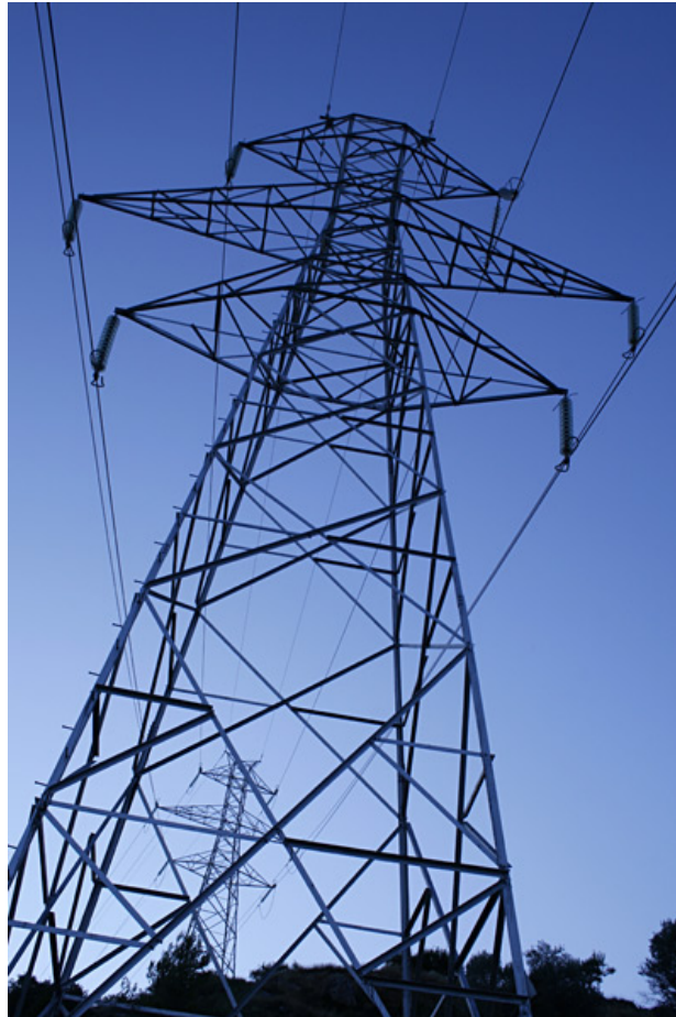
Figura 3. Línea de alta tensión apoyada en torre. Fte: http://www.ree.es
