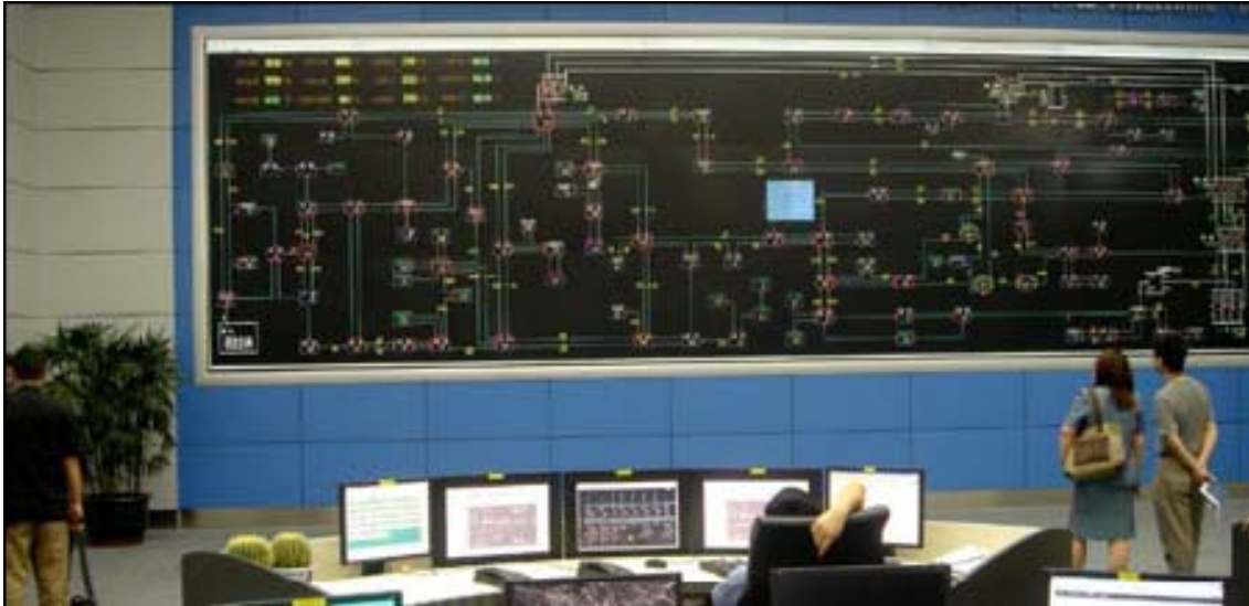
Imagen 2.5: Vista de una línea de proceso en un sistema de Videowall .
