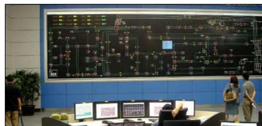
Imagen 2.2: Esta imagen muestra una vista de la sala de control de la planta de electrólisis de cloruro, para tres operadores.
