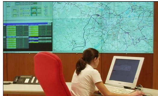
Imagen 2.1: En esta imagen se puede observar una vista de la sala de control de la planta de extracción de gas natural, para dos operadores.
