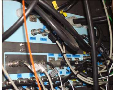
Figura 3.16. Conexión de los sensores a tarjetas ADAM.
