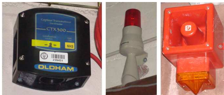
Figura 3.22. Detector de vapor de amoníaco y sirenas acústicas y luminosas.
