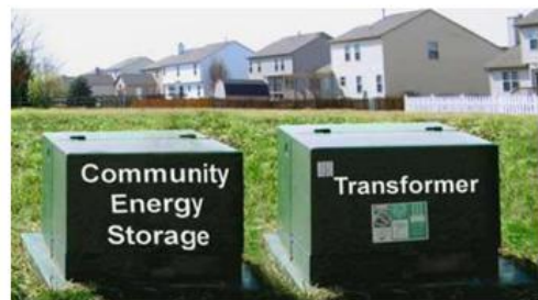
[AEP – CES Unit with Li Battery] - 단위용량 25kW/50kWh - 지중설치로 인한 유지보수 어려움
