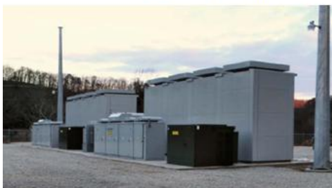
[AEP – CES with NAS Battery] - 단위용량 150kW/1MWh - 무정전 전환운전 기능 없음
