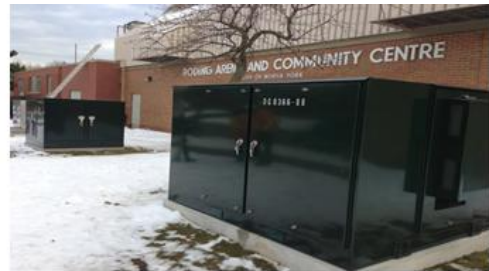
[eCAMION – CES Unit] - 단위용량 125kW/250kWh - 지중 배전선로 작업 필요
