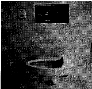
서고 내에 설치된 수도
