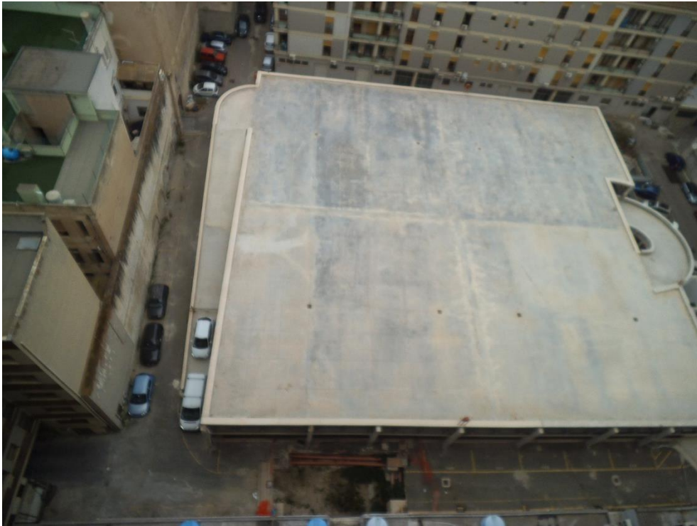
Fig. 1: Cagliari - Cortile Agenzia Laore: risulta visibile il taglio per la posa in opera della vasca antincendio e la situazione durante la sospensione dei lavori, prima della ripresa con l'intervento archeologico (foto geom. M. Floris, Laore). La vegetazione cresciuta durante il periodo di sospensione copre il piano della cisterna, unico manufatto visibile prima dello scavo.
