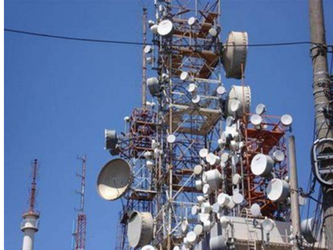
Figura 1-3 - Estruturas sobrecarregadas por antenas [3].
