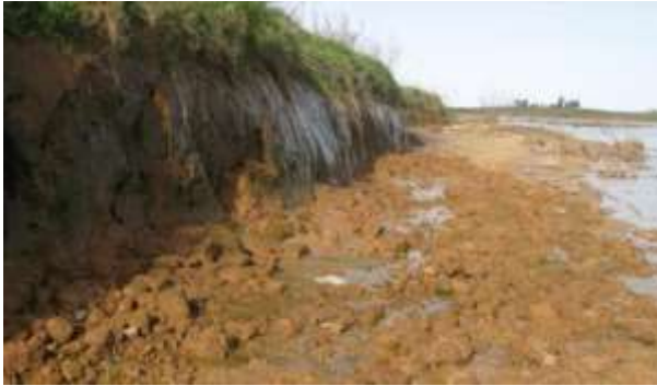
Foto del autor: Barranca sin muro de defensa
