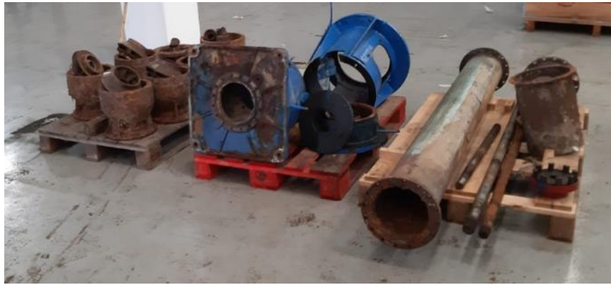
Figura 3.2. Una de las bombas desmontadas.
