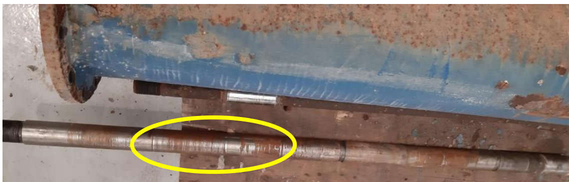
Figura 3.11. Eje de la bomba. Detalle de las marcas sufridas.
