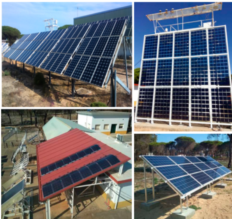
Figura 3.3 Campos fotovoltaicos. Fuente: INTA.
