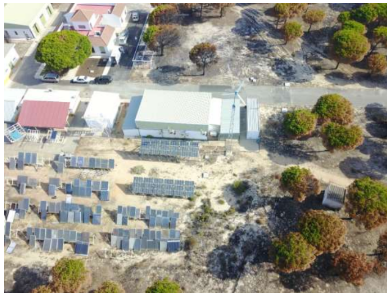
Figura 3.2 Vista aérea de la microrred. Fuente: INTA.
