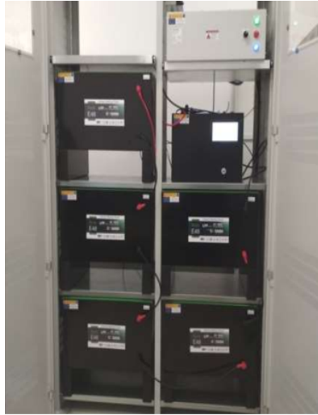
Figura 3.7 Baterías de ion litio. Fuente: INTA.
