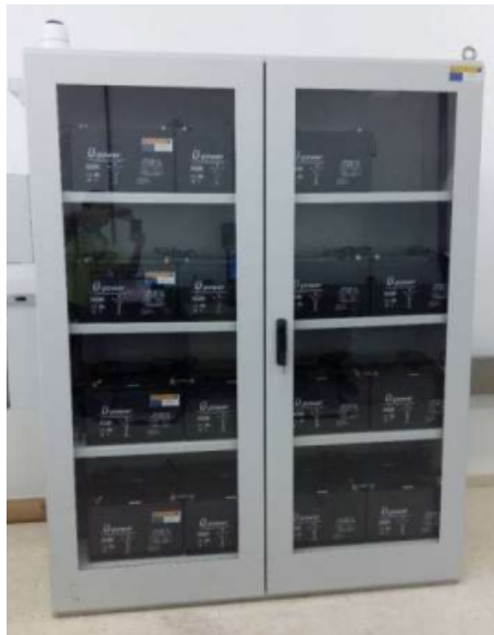
Figura 3.6 Baterías de plomo - ácido. Fuente: INTA.
