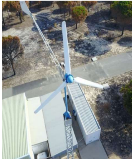
Figura 3.4 Aerogenerador. Fuente: INTA.
