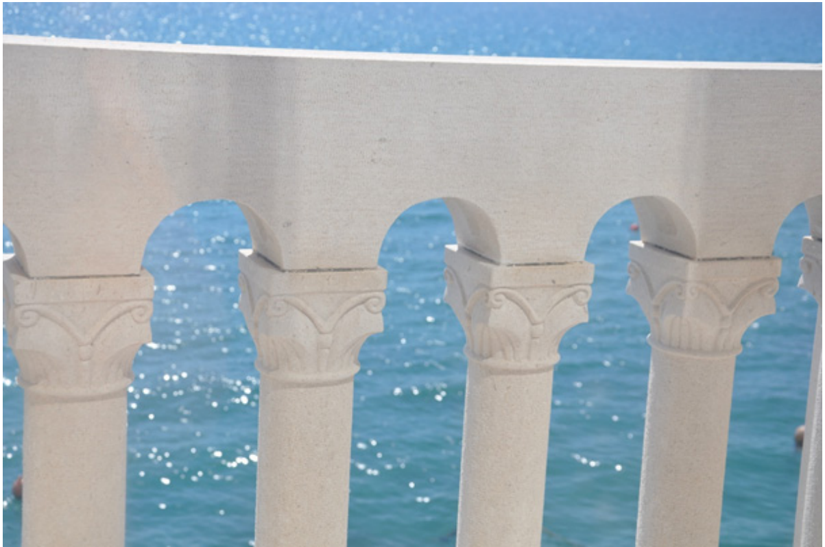
Slika 40. Kaštel Vitturi, stupići ograde balkona polivalentne dvorane na prvom katu, 2016.
