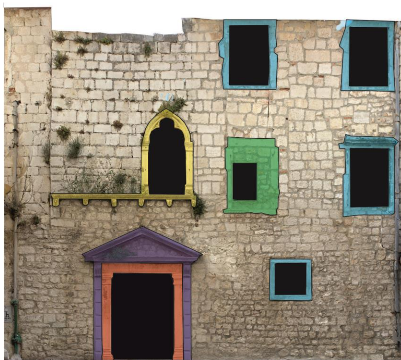
Slika 61: Sjeverno pročelje palače Galzigna s označenim otvorima zida: crveno- renesansni portal, ljubičasto- barokni portal, žuto- kasnogotička monofora i prozorska klupčica, zeleno- trag zatvorenog prozora u čijem dnu se nalazi ulomak dijamantnog niza, plavo- recentniji prozori (foto: autorica)
