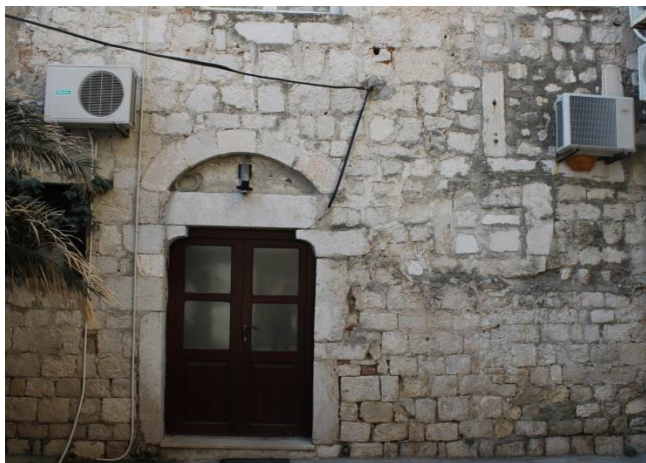
Slika 36: Dio zida s vratima i tragovima ranijeg prozora u dvorištu palače Benedetti, vjerojatno dio ranijeg zapadnog krila Kneževe palače (foto: autorica)
