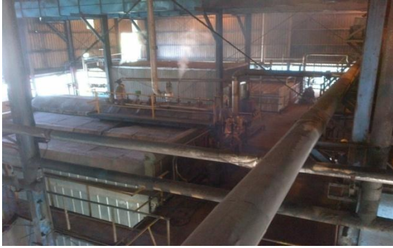
Gambar 9. lokasi stasiun boiler.
