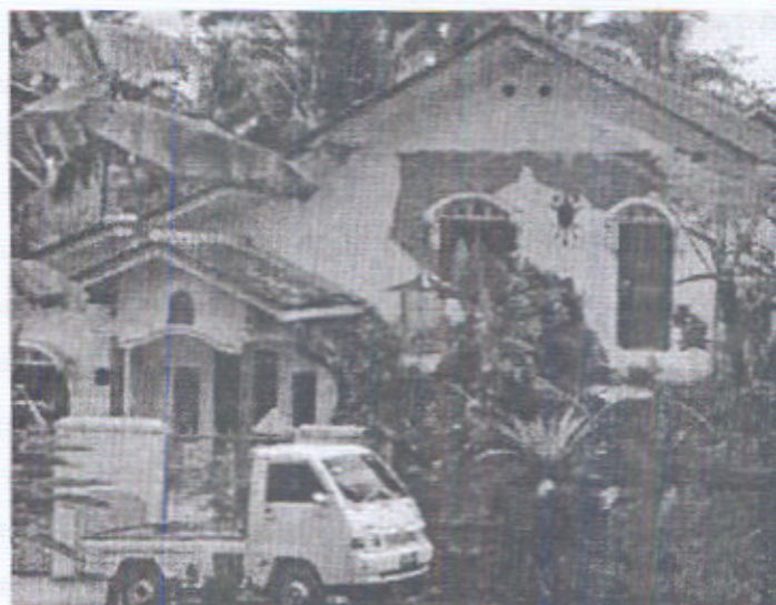
Gambar 7. Kerusakan pada bangunan yang strukturnya cukup baik
