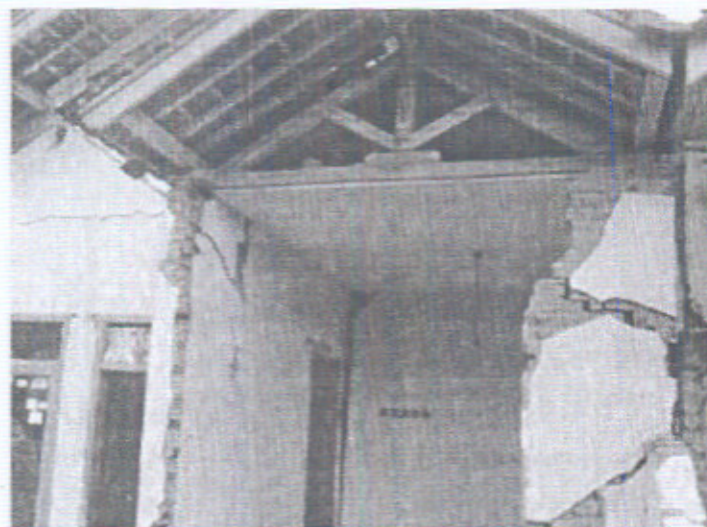
Gambar 6. Kerusakan pada bangunan yang strukturnya kurang baik
