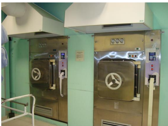
Entrada das autoclaves
