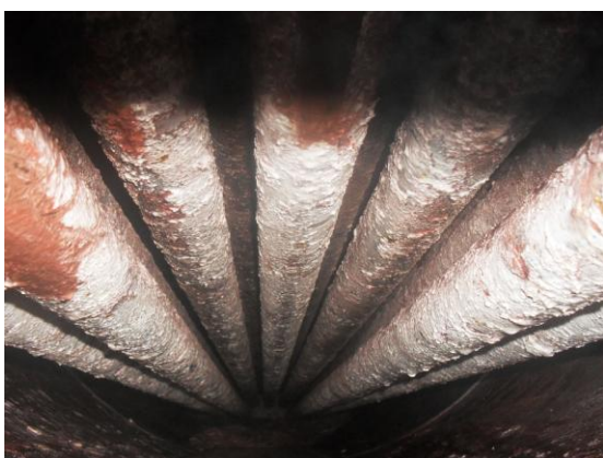
Tubos da caldeira *2
