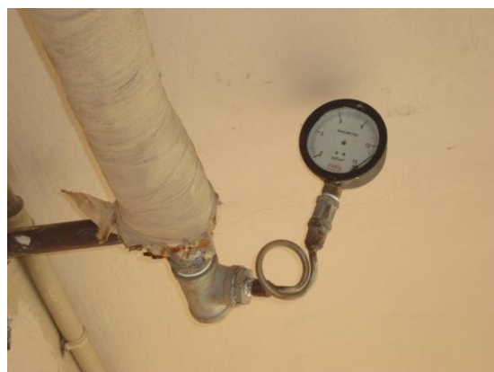
Manômetro quebrado (abastecimento geral)
