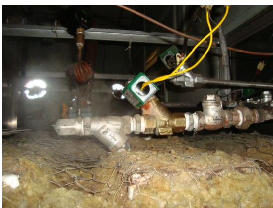
Válvula solenóide com vazamento
