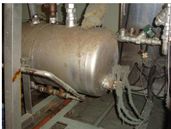
Sujidade nos dispositivos do equipamento
