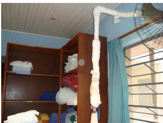
Rede de vapor protegida com tecido
