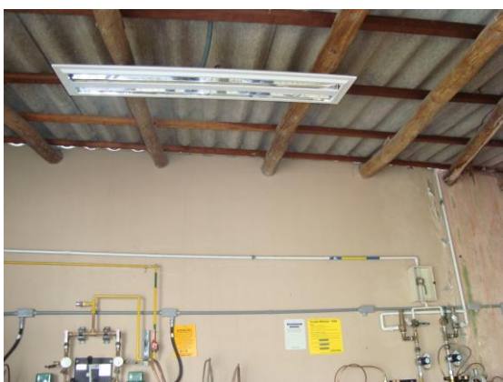
Suporte inadequado para o telhado 4
