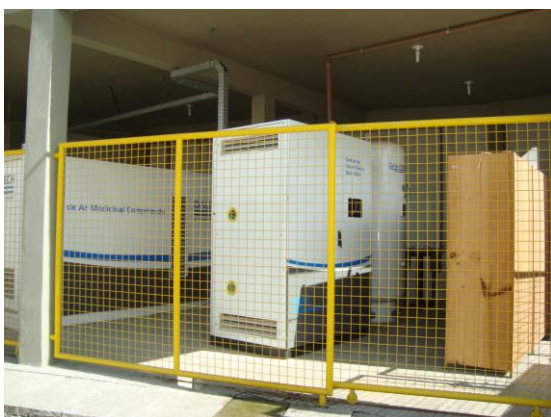
Ambiente exclusivo para central de gases
