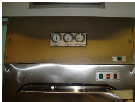
Manômetros e Manovacuumetro
