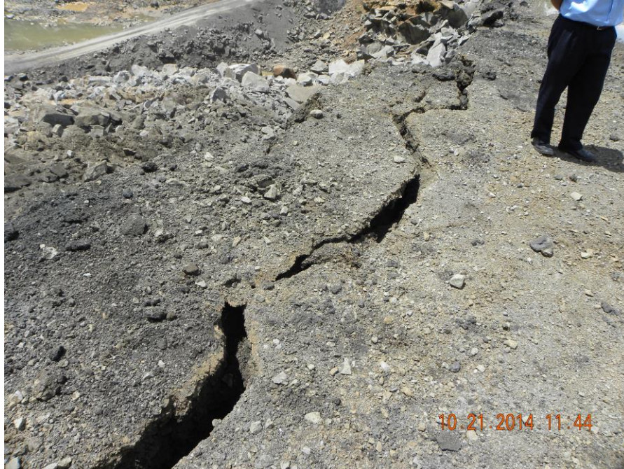
Figura 8 - Rachaduras na face livre da bancada
